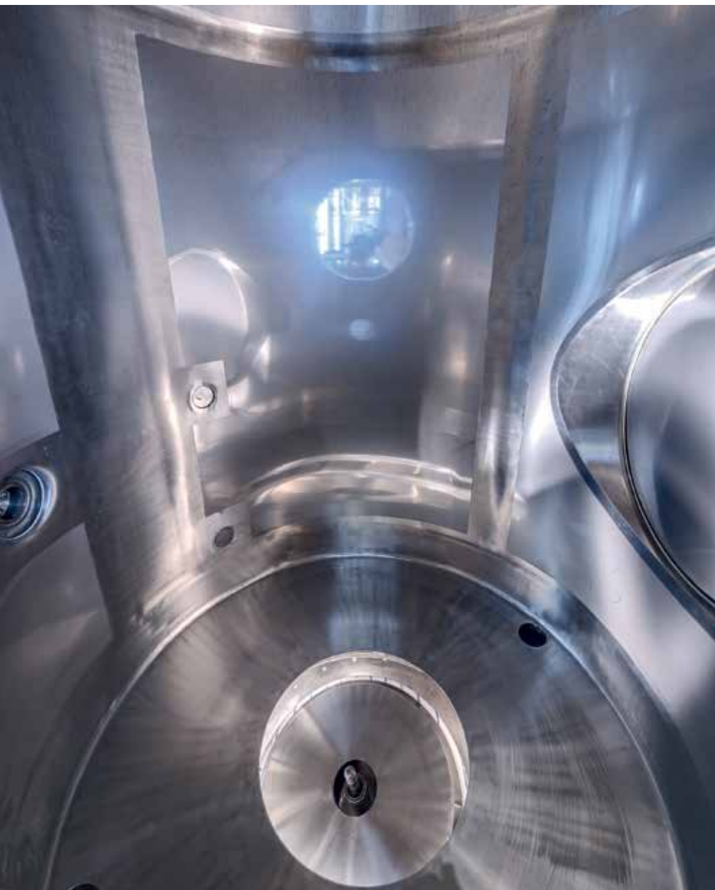
Sprühtrocknungsanlage im Technikum
